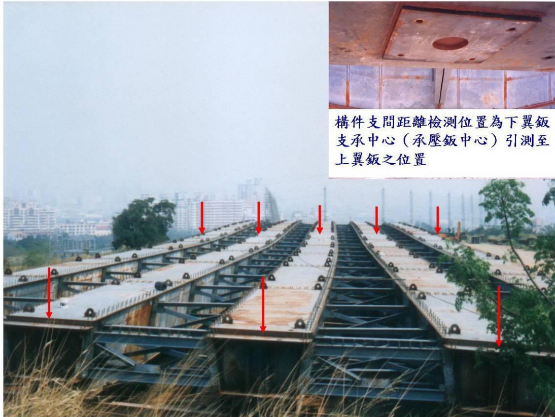
照片 39 支承處引測及檢測位置示意圖
