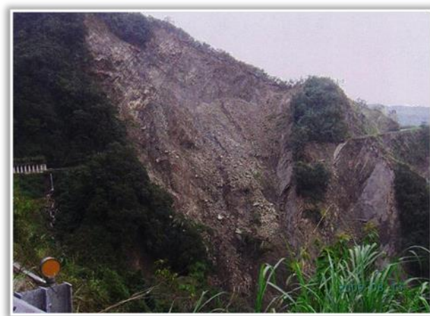
圖 2. 台 18 線 71K 崩塌相片
