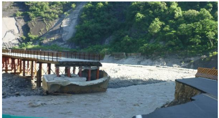
圖 3 引道位於河道中引道流失
